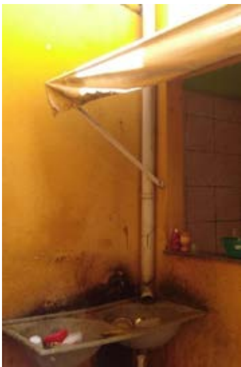
IMAGEM 7. Tubulação de águas pluviais em local inadequado
