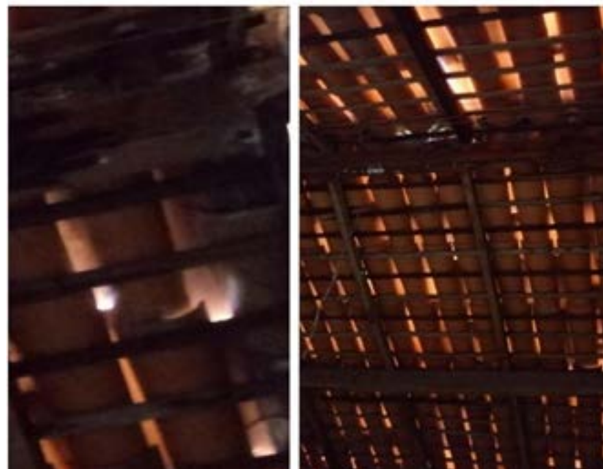
IMAGEM 9. Telhado com presença de goteiras
