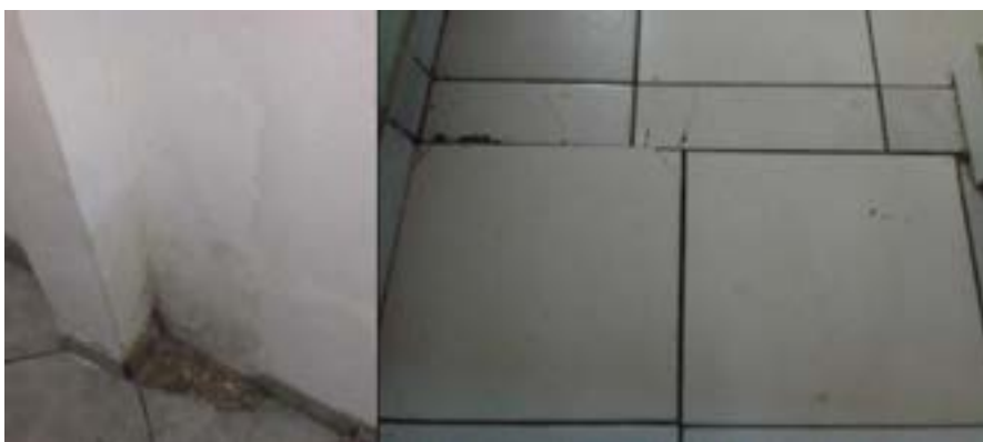
IMAGEM 8. Revestimento cerâmico deteriorado
